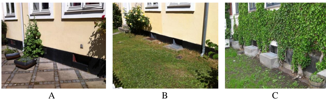
Figur 4.16 3 forskellige måder at sikre lyskasser/kældervinduer på A: Kant foran kældervinduet B: Lille opkant på lyskasse C: Stor opkant på lyskasse
