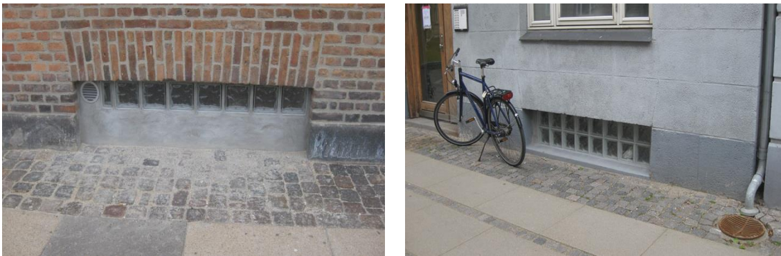
Figur 4.20 Eksempler på kældervinduer, der er erstattet med glassten
