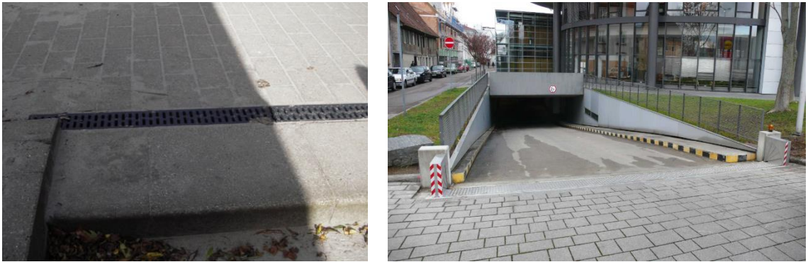
Figur 4.14 Linjedræn oven for en udvendig trappenedgang eller en garagedkørsel kan afskære tilstrømning af regnvand fra terræn
