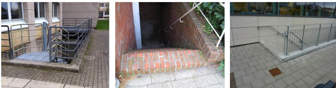
Figur 4.8 Hævede kanter rundt om kældernedgange
