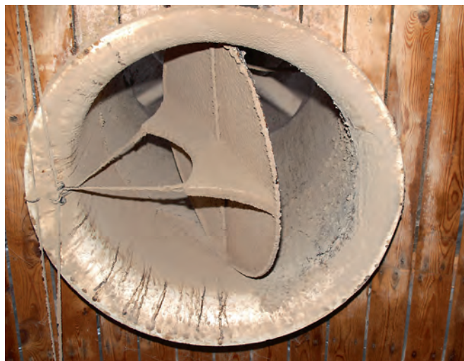
Reduceret ydelse på grund af støv.
