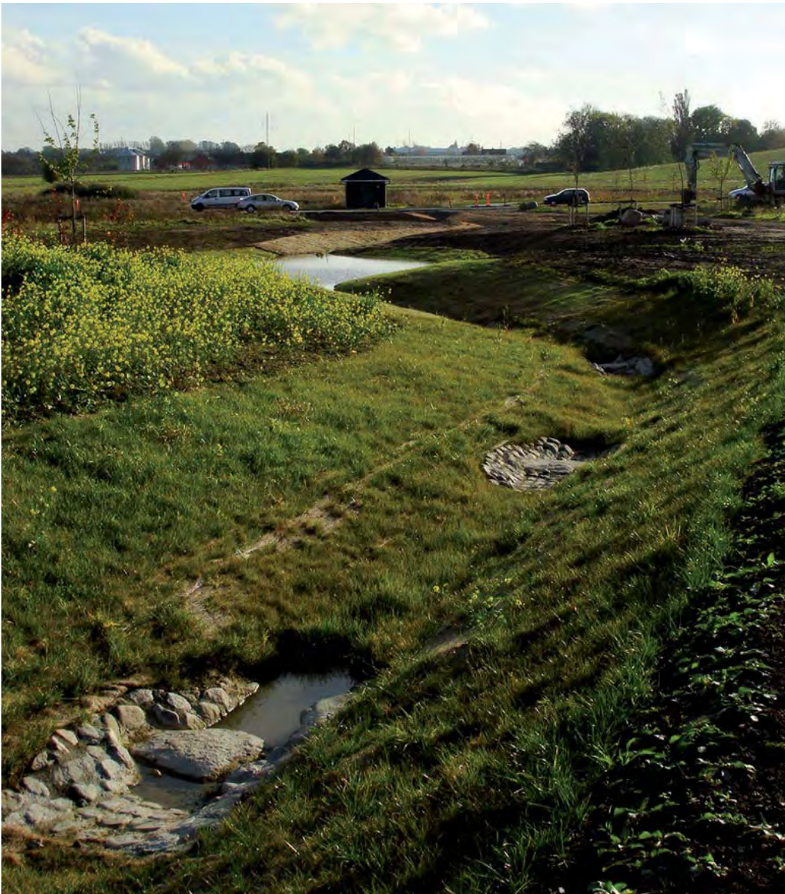
Anlæg til opsamling af regnvand i Trekroner. Foto: Ole Fryd
