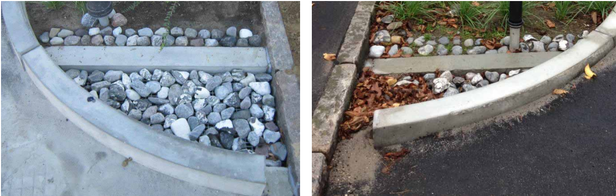
Figur 11a: Indløb -forbassin. Til venstre: Nyanlagt forbassin med støbt bund og søsten. Til højre: Forbassin efter brug. Indløbsbassin med sten er vanskeligt at rense op. Man kan også spørge om forbassinet har nogen funktion efterhånden som det fyldes op med blade og sediment; hyppig drift er i hvert fald en forudsætning. Et stærkt græsdække er sandsynligvis den bedste måde at modtage det indkommende vand på. Alternativt kan små bunddækkende buske eller stauder, der kan tåle årlig nedklipping med buskrydder overvejes. En tredje mulighed er at lave et forbassin som vist her, men dækket med en rist.
