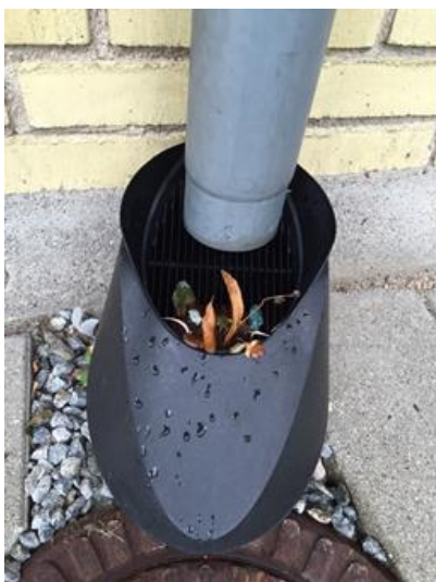
Figur 5.2. En regnvandsventil skal efterses, og blade skal fjernes, så tagvandet ikke utilsigtet løber ud på overfladen
